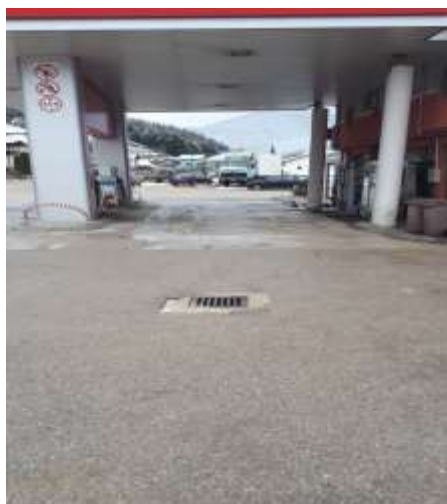
Slika 6. Sabirni šaht za prihvatanje atmosferske otpadne vode
