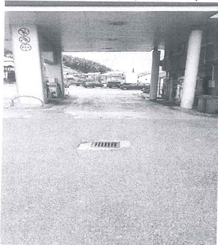
Slika 12. Sabirni šaht za prihvatanje atmosferske otpadne vode
