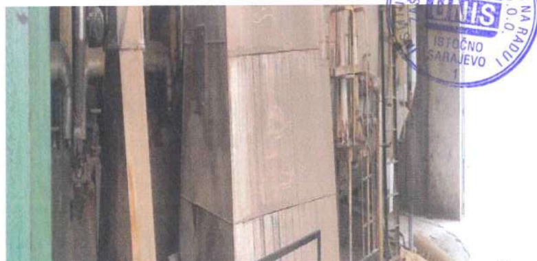
Slika br. 6. Kotlovnica preduzeća "Drvne industrije Šipovo" d.o.o. Šipovo
