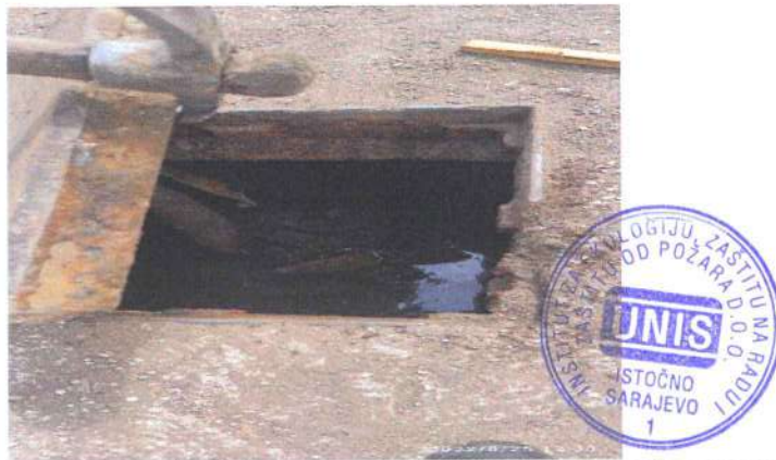
Slika br.3. Primarni sabirni odvod iz bazena prije ispusta u kanalizacionu mrežu
